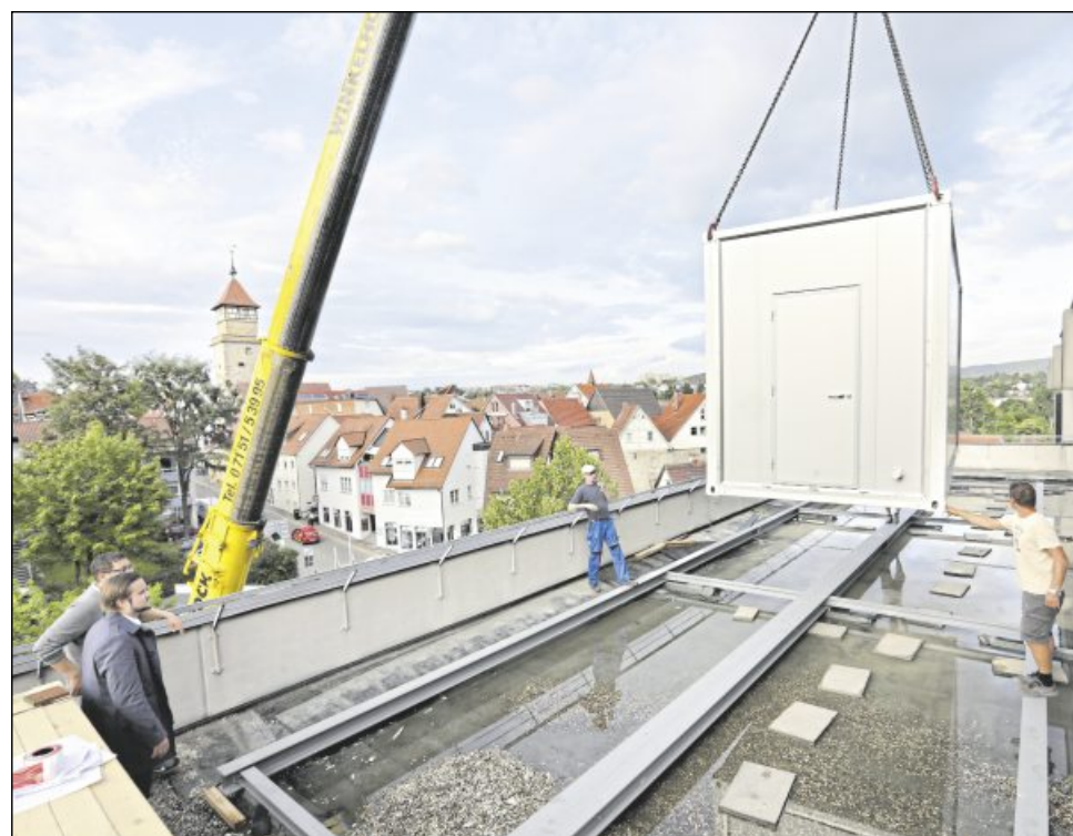
Mit einem Kran wurden Container auf die Dachterrasse vor der Bettenstation der Zentralklinik gehievt und miteinander verbunden. Für die kommenden Monate dienen sie als OP-Bereich.
